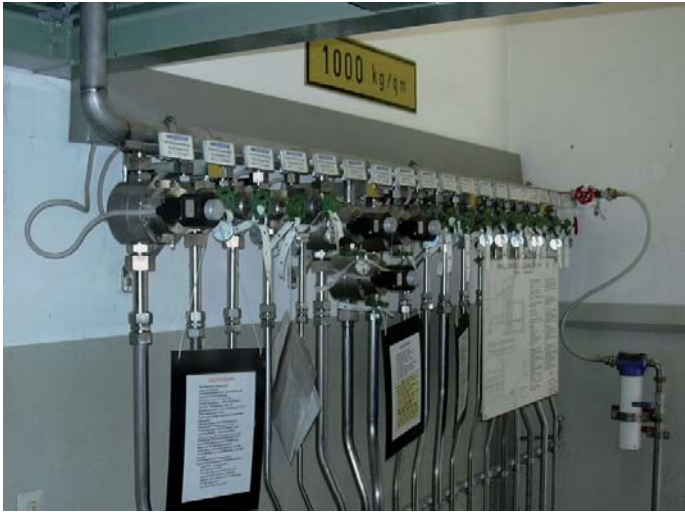
Bild 4: Ventilstation bei Bayer in Uerdingen (Quelle FOGTEC)
