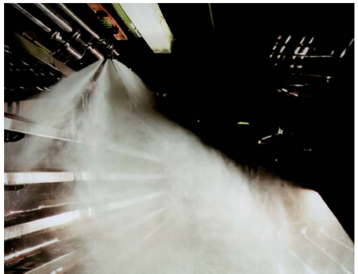
Bild 5: Auslösung des Wassernebelsystems in einem Kabelkanal (Quelle: FOGTEC)
