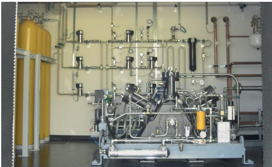
Bild 6: Erdgastankstellen-Anlage mit GSR-Hochdruckventilen (Quelle: RMG)
